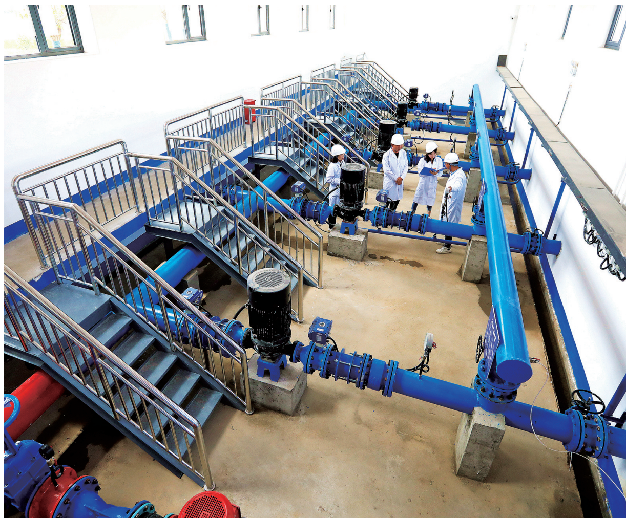
汉台区大力推行城乡供水一体化建设，通过组建农村自来水服务中心负责农村饮水安全的水质监测、智慧水务管理工作，从水源、供水管网、用户等全过程实现城乡供水数据化管理，确保群众用水安全。崔建荣 摄
