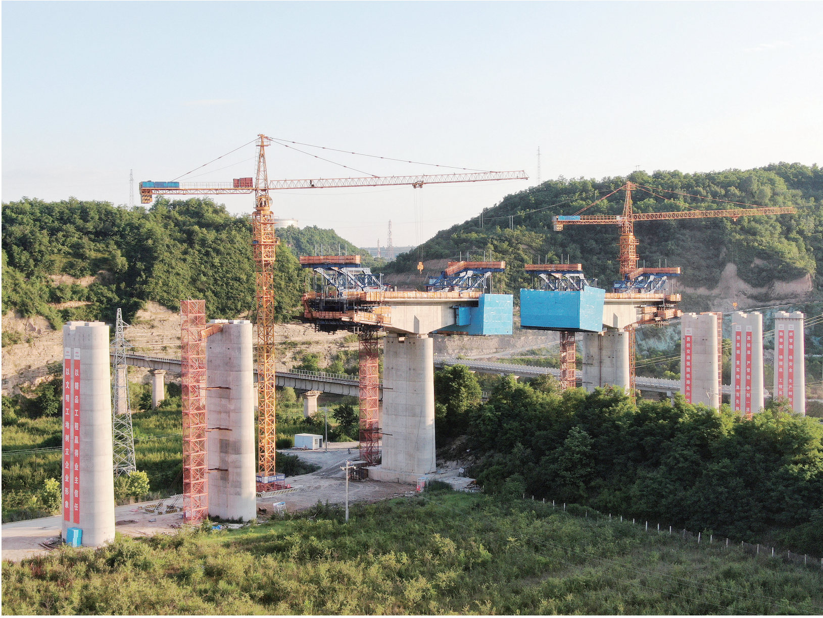
位于黄土高原地区的西(安)延(安)高铁延安洛川段施工现场一片忙碌,参建单位抢抓工程进度,全力推进建设进程。西延高铁是国家高速铁路网包(银)海高速铁路通道的重要组成部分。线路建成投入运营后,西安至延安的运行时间将从目前的2.5小时缩短至1小时左右。这是位于延安市洛川县的西延高铁XYZQ-8标段交口镇北洛河特大桥施工现场(6月25日摄,无人机照片)。
