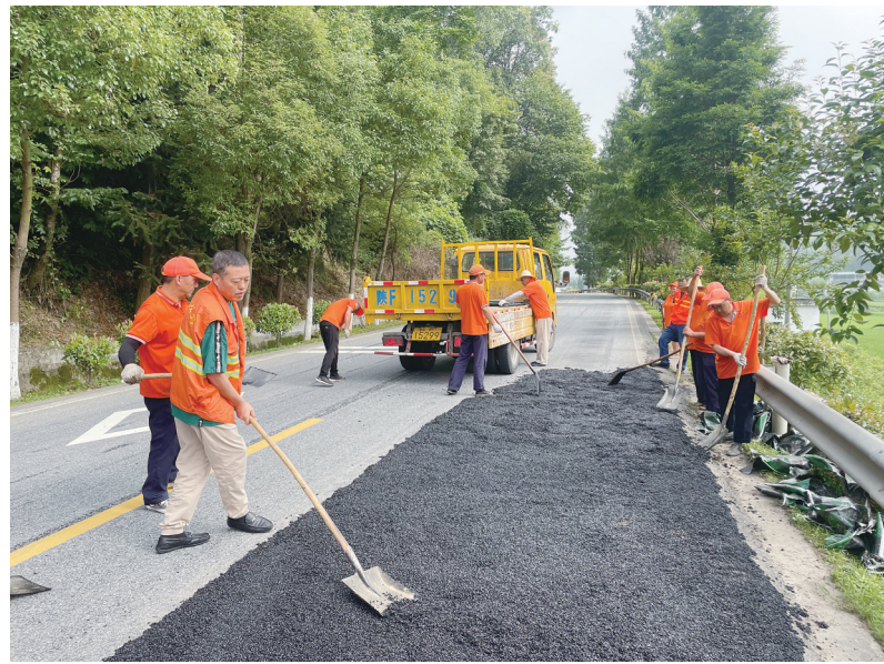
近日，市公路局南郑公路段在做好日常养护和防汛抢险的同时，加大公路预防性养护力度，紧抓有利天气，迅速完成辖养公路路面裂缝、坑槽等病害修复处置工作，有效延缓路面病害发展速度，延长公路使用年限。
