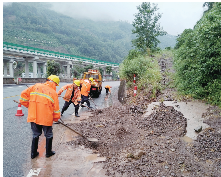
9月11日，受强降雨天气影响，西乡境内国道千线多处路段发生边坡坍塌。市公路局西乡公路段迅速组织抢险队员冒雨进行保通作业，截至9月11日下午3时，共计清理泥石流150余立方米，落石160余立方米。张东 刘艳丽 摄
