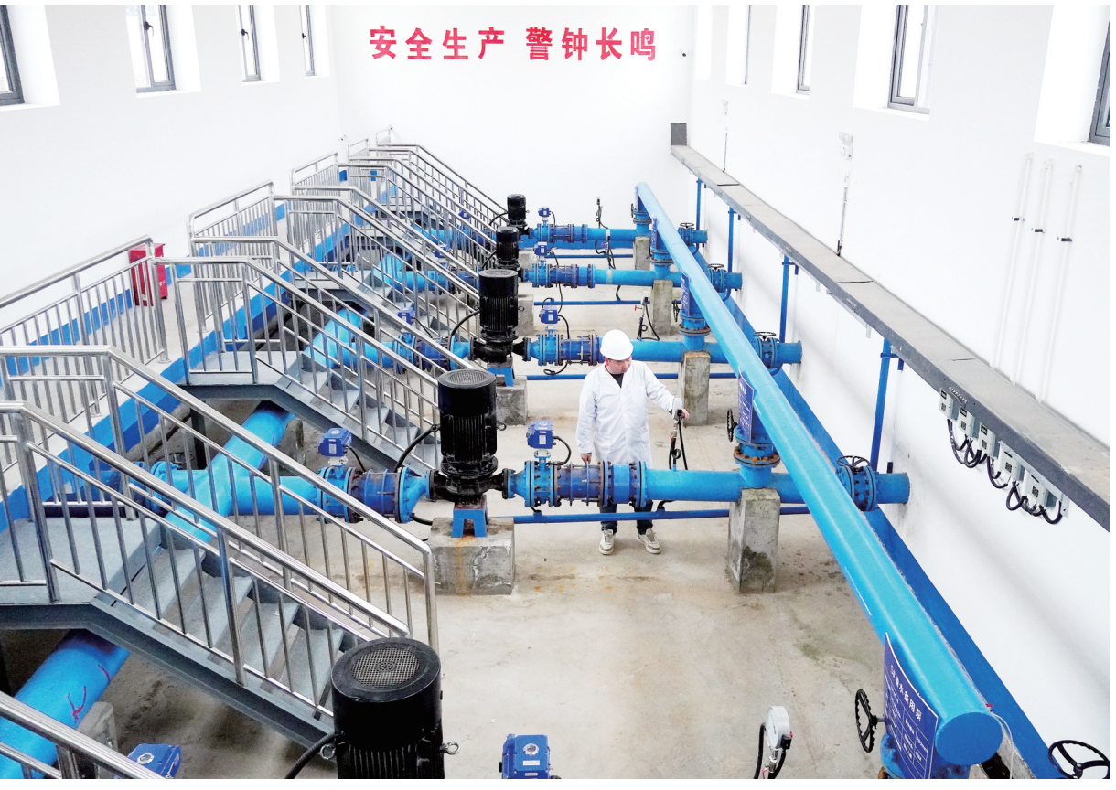
日前,汉台区老君水厂工作人员在调试设备。近年来,汉台区把农村饮水安全工作作为重大民生工程,大力推进城乡供水一体化建设,着力提升乡村群众用水质量,实现与城区供水标准一致、服务一致、管理一致。 马瑜 摄
